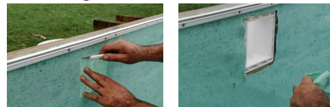
Fixing of the skimmer joint Fijación de la primera junta del skimmer Fixation du 1er joint de skimmer Befestigung der ersten Dichtung des Skimmers Fissaggio del primo giunto dello skimmer Bevestiging van de eerste pakking van de skimmer Fixação da primeira junta do skimmer
