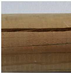
Cracks/Grietas/Fente/Risse/ Crepe/ Barsten/Fendas
